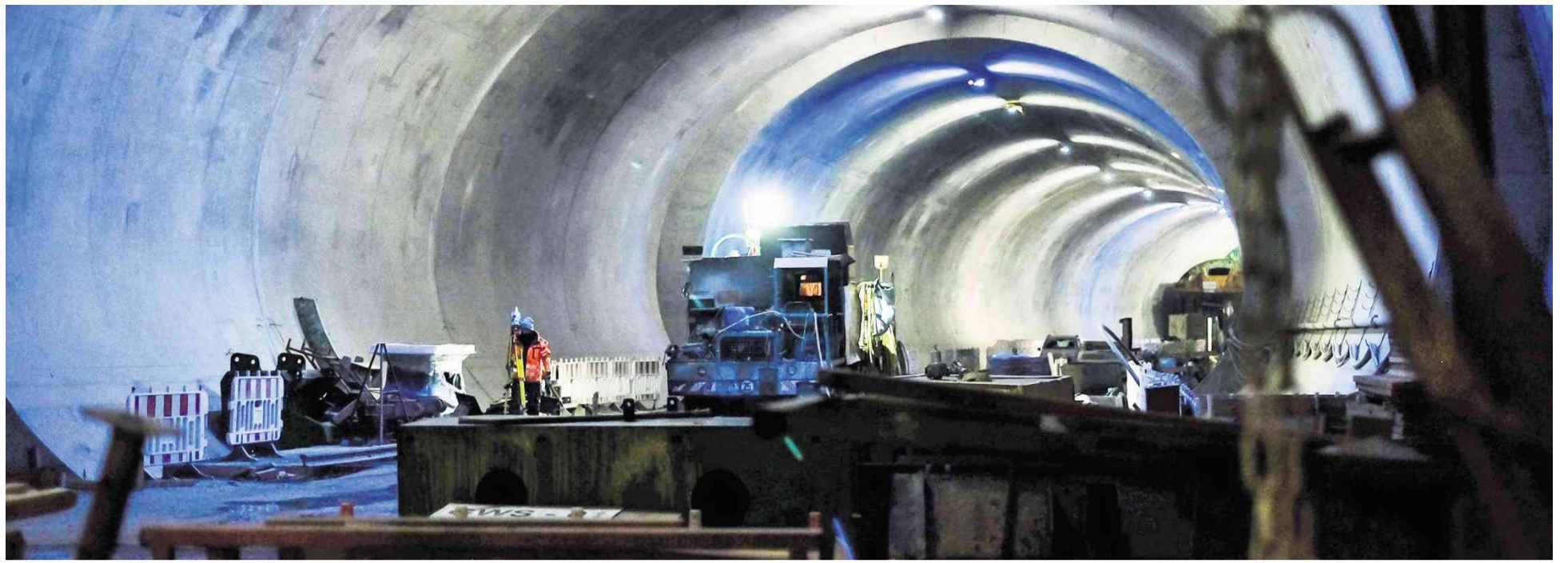
Umstritten: die Sicherheit in Tunneln im Fall eines Brandes
